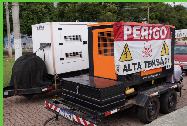
01 Gerador de Energia
