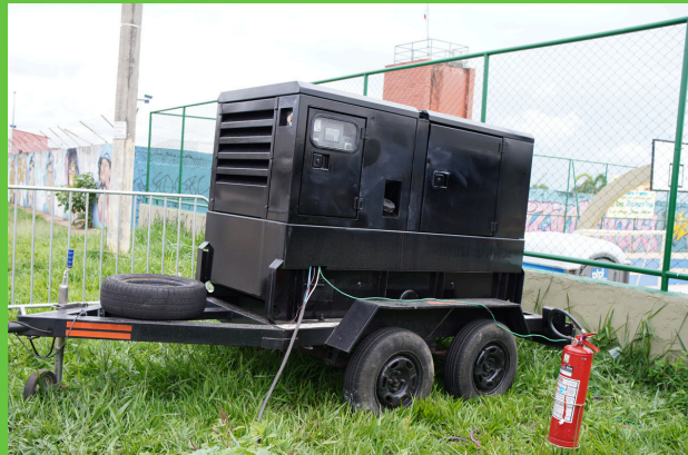
01 Gerador de Energia
