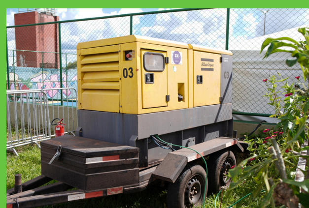
01 Gerador de Energia
